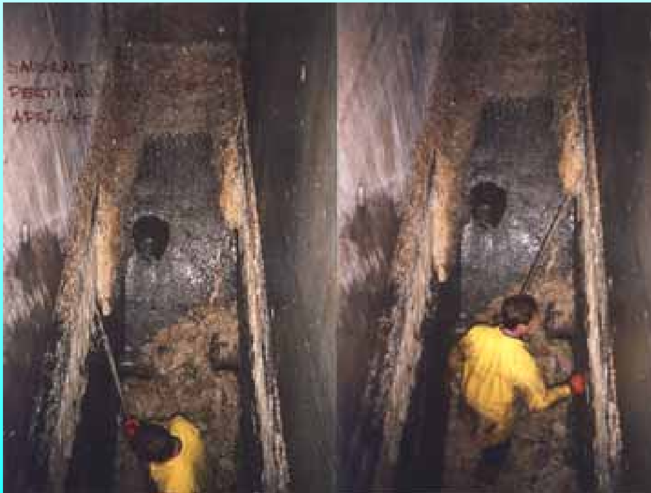
Fettanlagerungen an den Wänden eines Pumpwerkes
