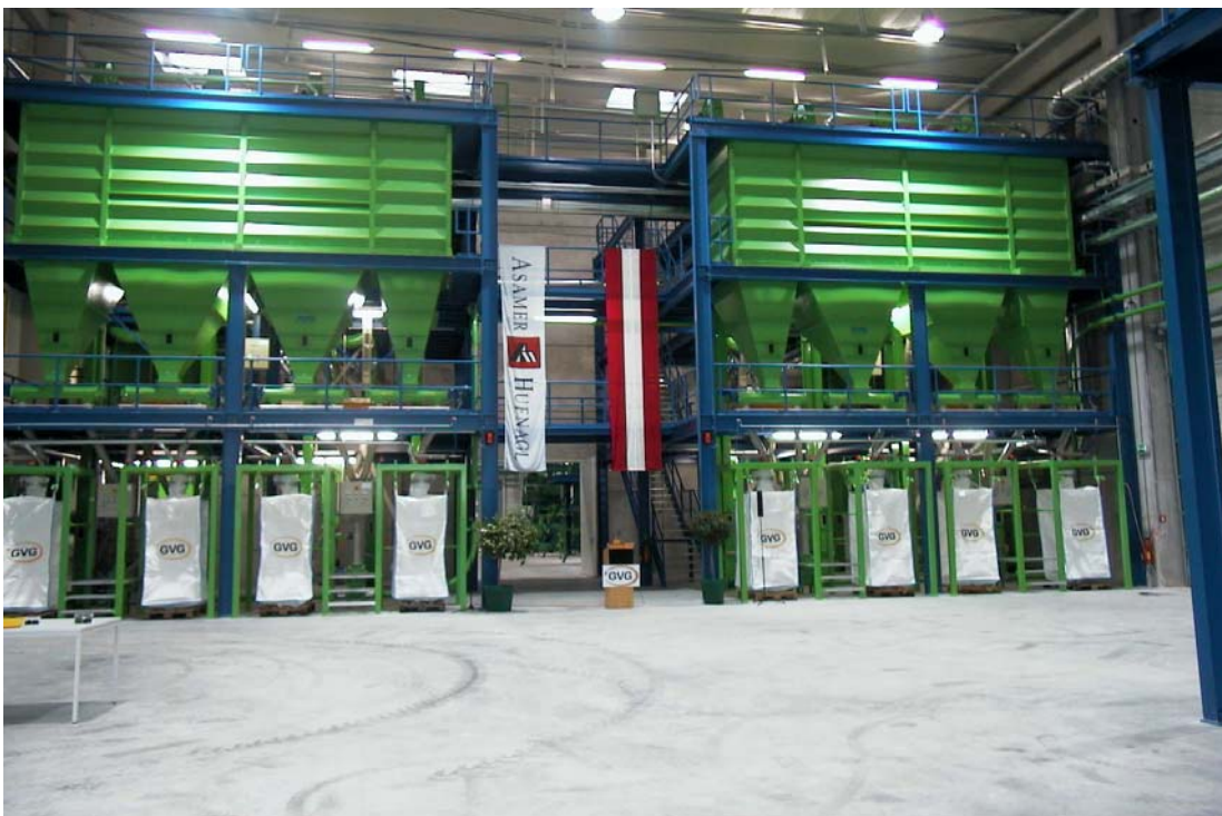
Abb.4.: Blick auf die Siebanlagen für Gummimehle und Gummigranulate (GVG, 2003)
