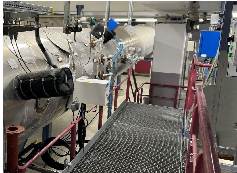
Reingaskanal mit Messtechnik
