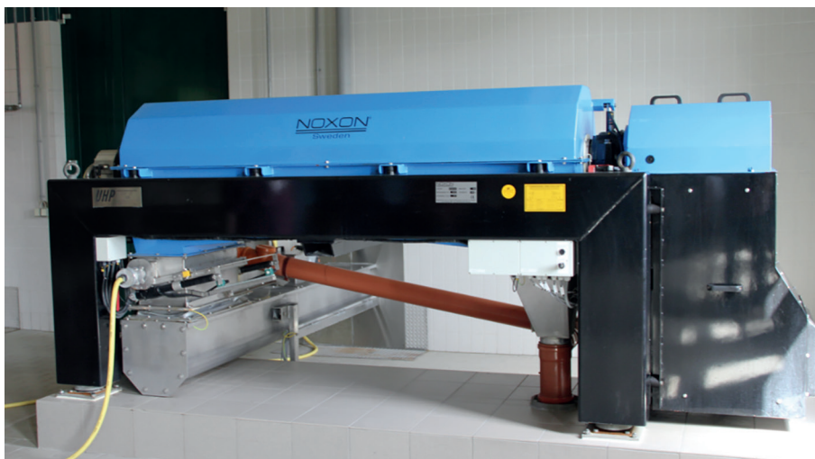
Abb. 7 Dekanter der Kläranlage Bruck an der Leitha (eigene Aufnahme)
