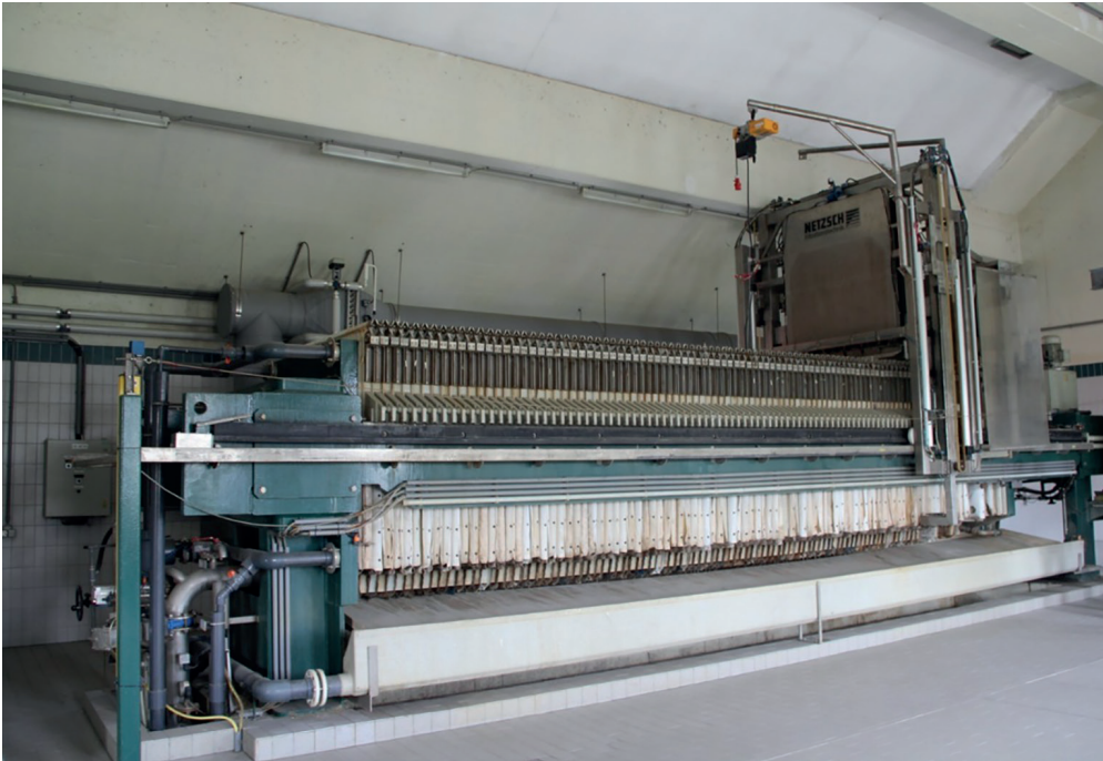
Abb. 9 Kammerfilterpresse der Kläranlage Bruck an der Leitha (eigene Aufnahme)
