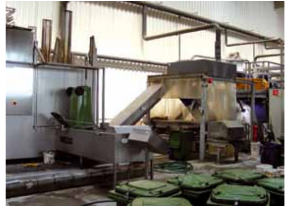
Reinigung und Desinfektion der Sammelbehälter im Behandlungsbetrieb (Foto: BMG)
